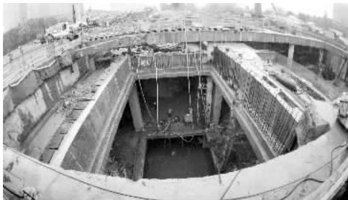
发生河水倒灌的杭州地铁4号线施工现场 新华社记者 韩传号 摄
