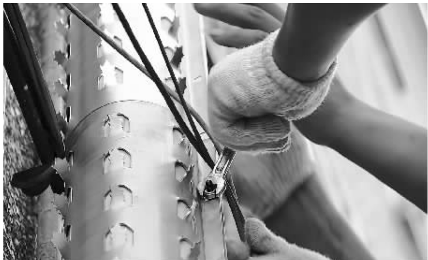
7月23日上午,施工人员在给外墙落水管穿上带刺的“外衣” 葛小林 摄
