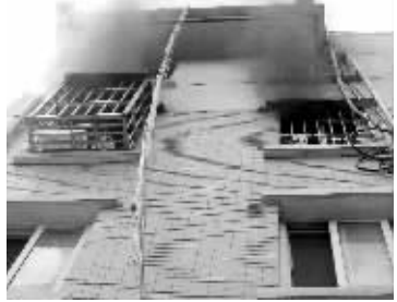
起火房间位于5楼
