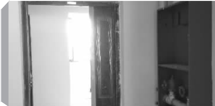
防盗门内的消防栓
