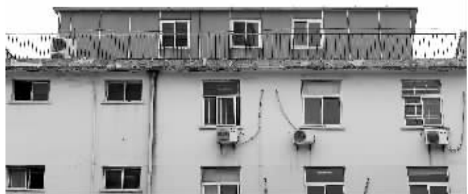
雨花西路99号楼顶的违建 现代快报记者 施向辉 摄
