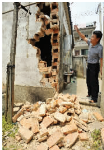
这户居民家的墙角发生倒塌
