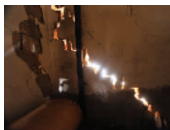
光线从居民家墙上的裂缝透进来
