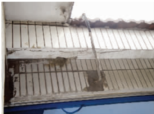
有些地方已经出现裂缝
