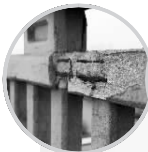
护栏水泥严重脱落
