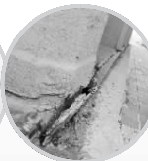
桥头堡边缘有裂缝
