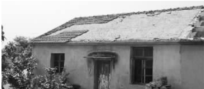
屋瓦被扒掉一部分
