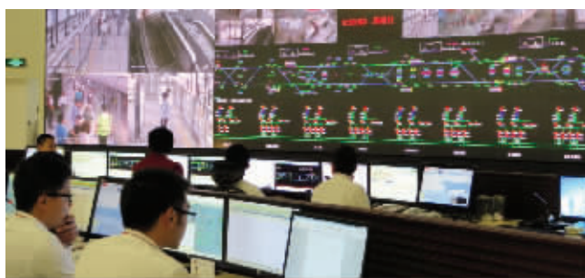
在控制中心,地铁运行情况一目了然 薛晟 摄
