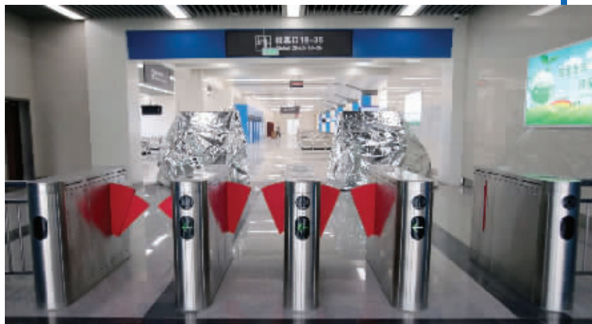
检票口闸机已经安装完毕
