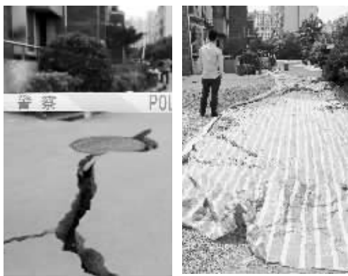
开裂的路面已经被水泥填埋
