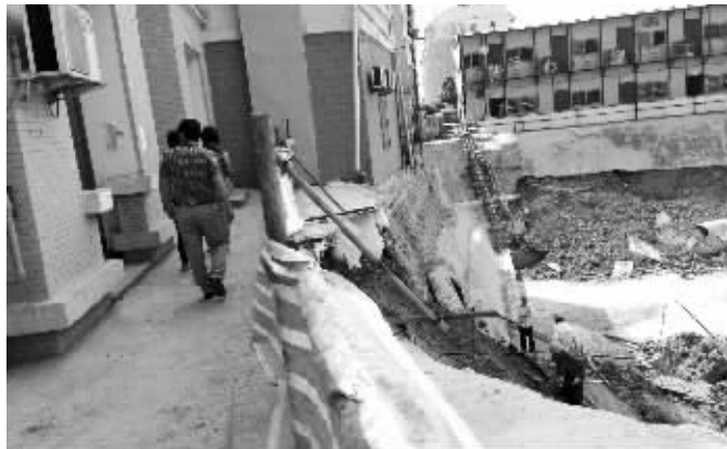
塌陷的工地紧挨着居民楼
