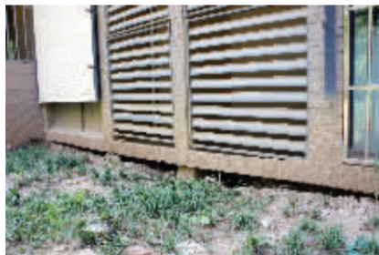
楼体与地基之间出现空洞
