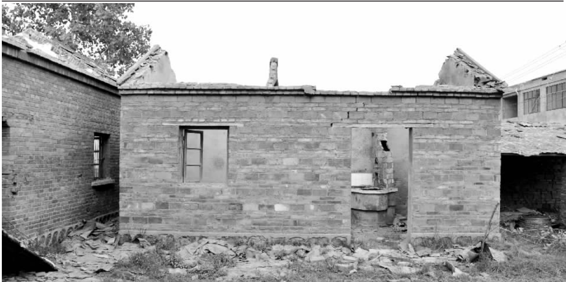
没了屋顶、门窗残损，碎砖烂瓦遍布，王家兄弟的老宅成了一处废墟
