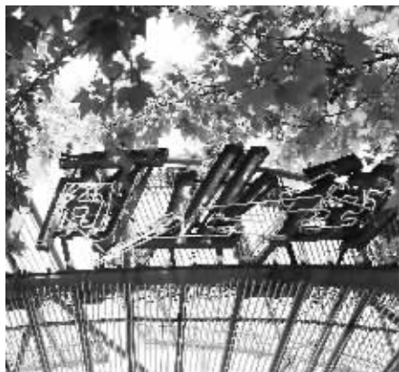
南湖东路上的灯光拱门破损严重,有的灯管还脱落了
