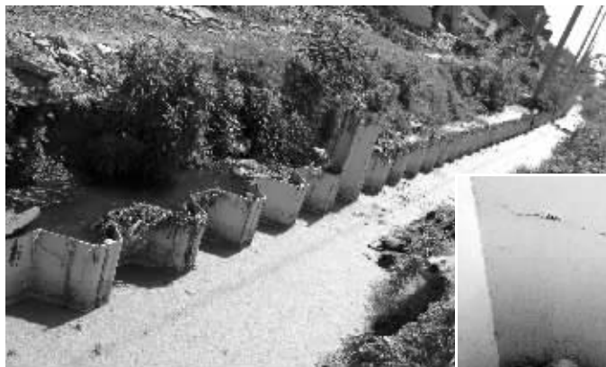
大图:运河拓宽工程中在打的钢板桩;小图:居民家中出现裂缝
