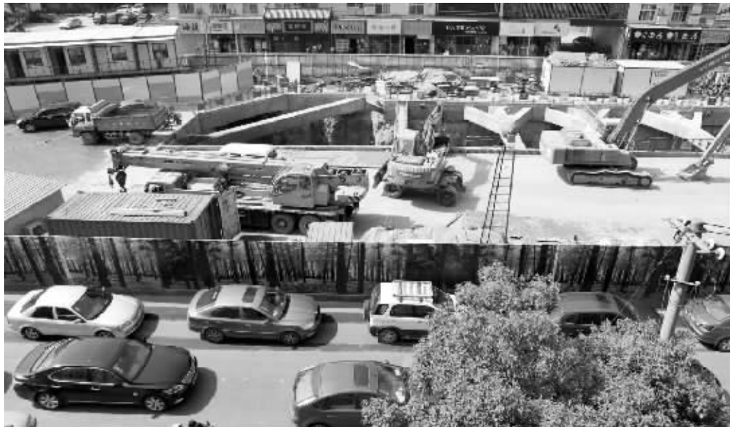
渗水险情一出现,地铁方面紧急启动应急预案,调集一百多名工人及时抢修
