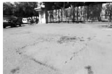
记者发现只有靠近北京东路73号附近的路面有轻微的下陷,路面也没有明显的积水
