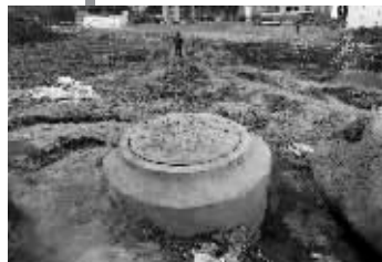
事发窨井已被盖上
