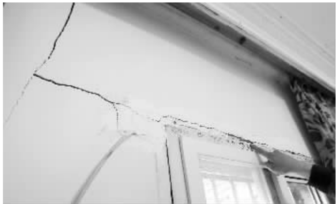
家里墙壁上出现裂缝 现代快报记者 马晶晶 摄
