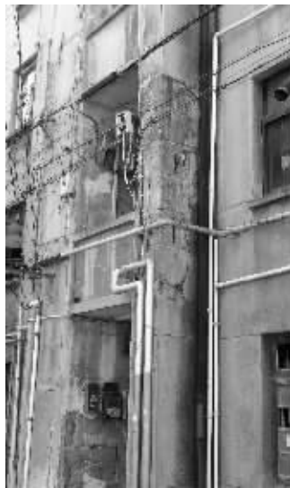
钟楼新村外墙严重脱落
