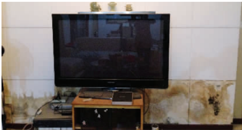
客厅墙面已经出现了大面积的霉斑
