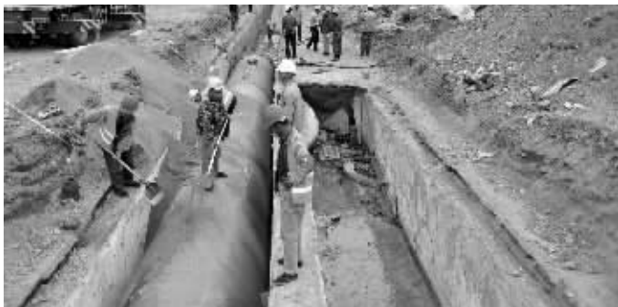
兰州重新铺设输水管道取代受污染自流沟 新华社记者 陈斌 摄
