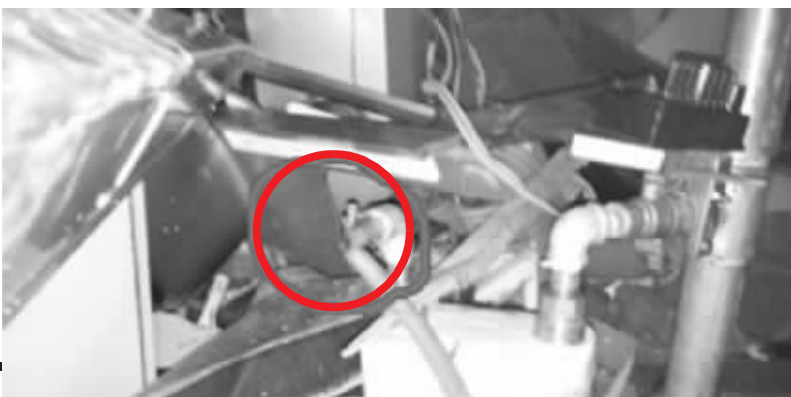
燃气管上有切割痕迹,像是人为造成的 微博图片
