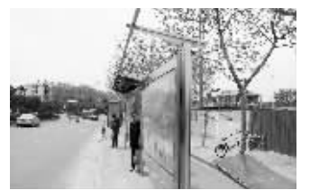
钟灵街公交站广告牌顶篷掉落
