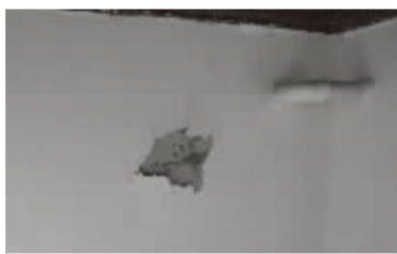
邓先生家墙面乳胶漆多处开裂
