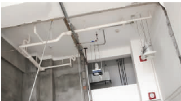
如果消防管道不拆除，业主以后在隔层就只能低头行走了
