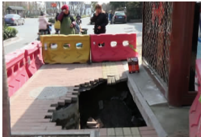
塌陷的人行道 久建供图
