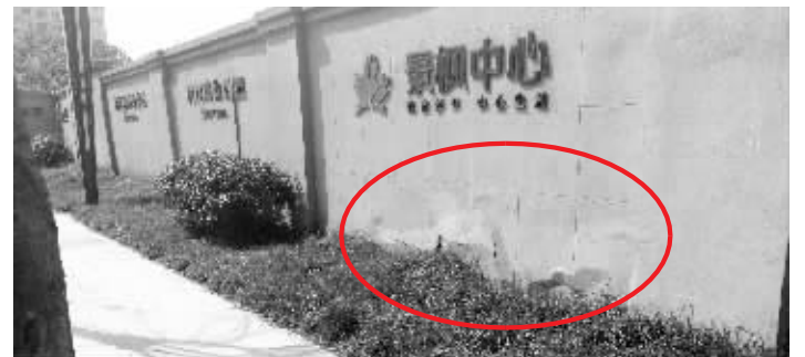
墙体下方出现了不少裂缝和空鼓
