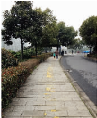
盲道脱落很严重
