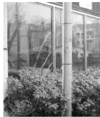
狒狒馆玻璃上的裂痕 报料人供图
