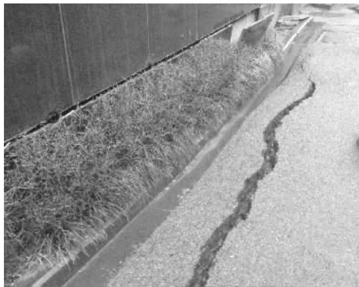
禾嘉大厦外围地面开裂非常明显
