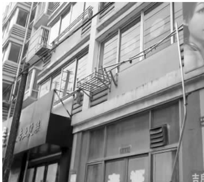
二楼的晾衣架被砸坏 通讯员 供图
