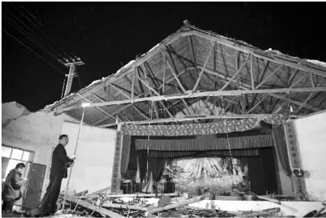
这是2月13日拍摄的浙江磐安万苍乡雅庄村会堂坍塌事故现场 新华社发
