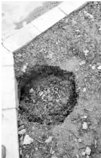
居民楼旁的草坪出现下陷 现代快报记者 顾元森 摄
