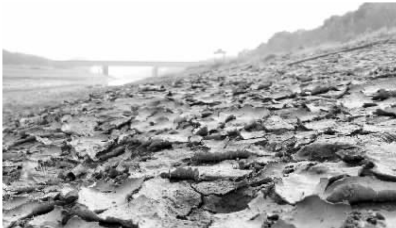
胥浦河开裂的河床
