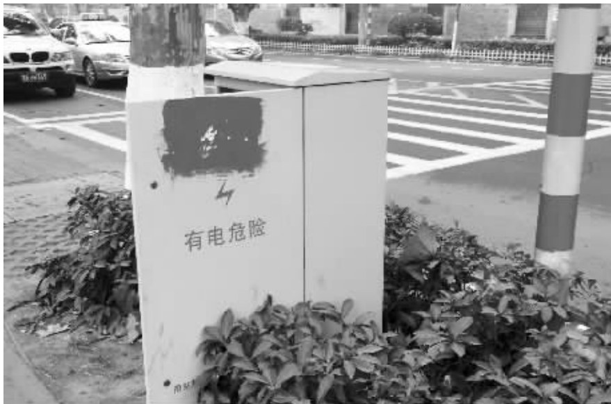
控制箱上写着“有电危险” 现代快报见习记者 廖健伟 摄
