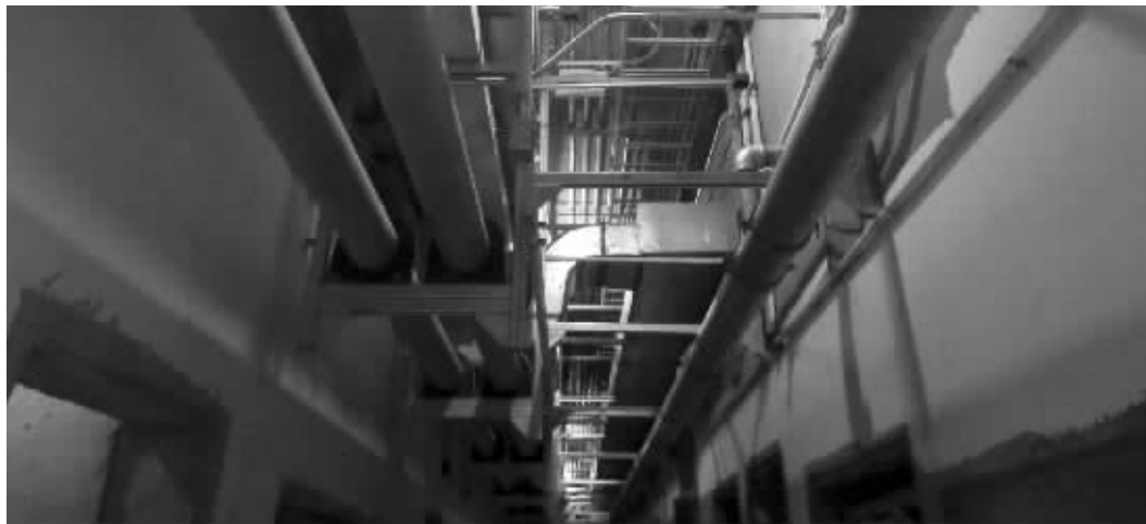
在梁溪大桥地铁站地下站厅层的设备管线主走廊上方,在宽1.8米、高2米的空间里,既要密布30多根粗根管道,还要留出0.5米宽的检修人员上下的空间
