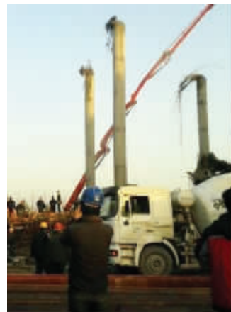
坍塌现场 网络图片
