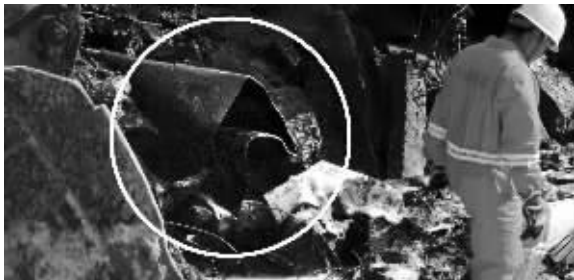
圈出处为断裂的输油管道
