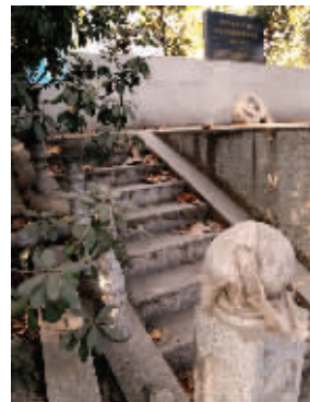
底座一侧的护栏已经倒塌 现代快报记者 刘玉莹 摄
