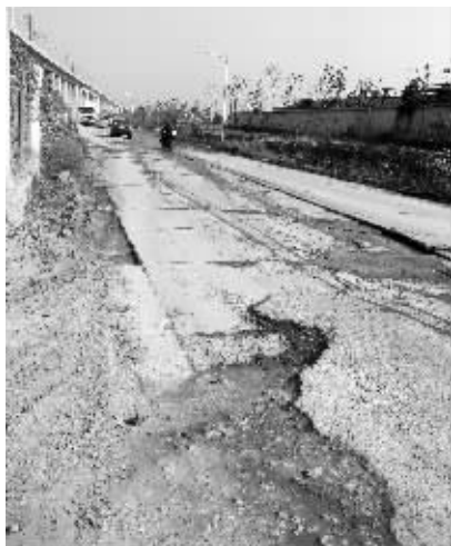
路面坑坑洼洼损坏严重
