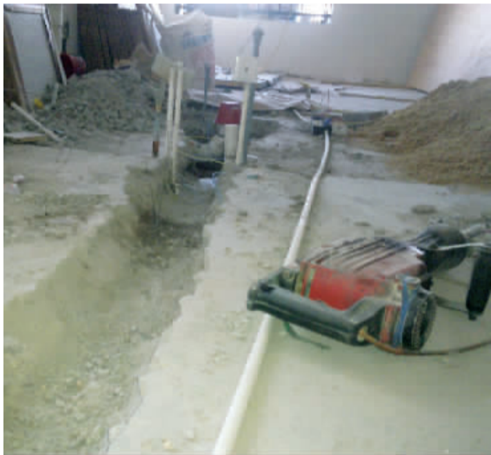
地面被挖开了一道约30厘米宽、20厘米深的沟槽,整改触目惊心
