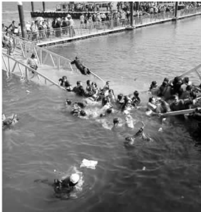
江西庐山西海风景区码头引桥发生塌陷
