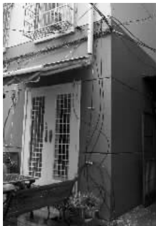
培德里小区雨水管距地面3米多 现代快报记者 李雨洋 摄
