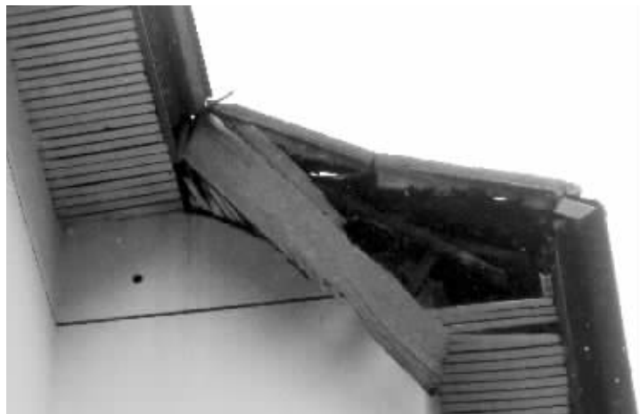
三条巷36号出新施工不彻底,屋檐摇摇欲坠看着很危险
