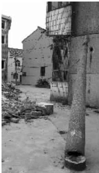
斜靠在墙上的电线杆已齐根折断
