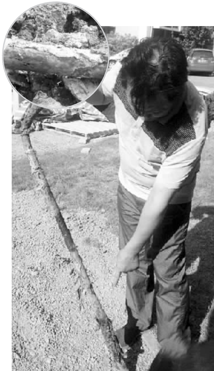
锈迹斑斑的煤气管道 (请供图网友来领稿费)
