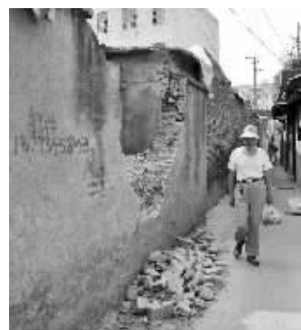
院墙倒塌，露出个大窟窿 其定 摄 倒塌的危险。附近的居民希望校方能尽早加固危墙，以免倒塌后砖头砸到路过的学生。 其定 丁宇
