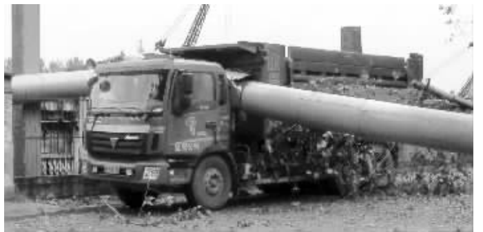
热气管道被渣土车拉断 久建 摄
