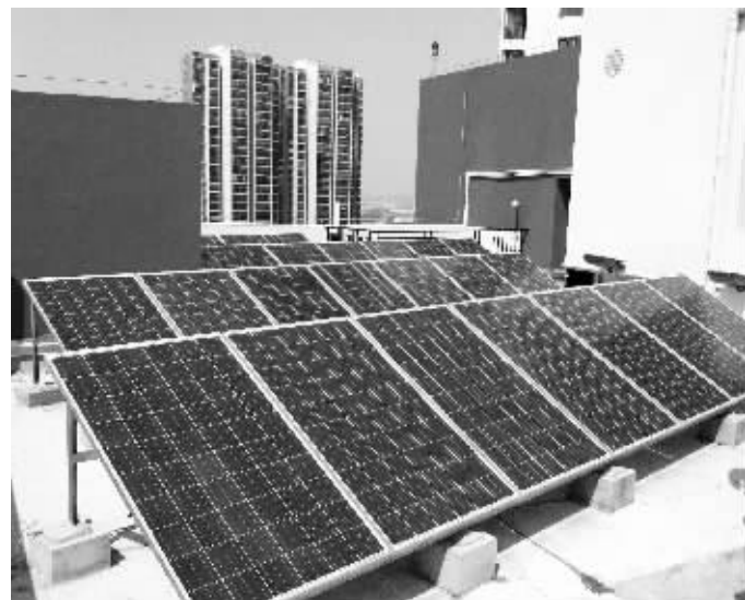
花郡家园楼顶的太阳能光伏电池板 城管供图
